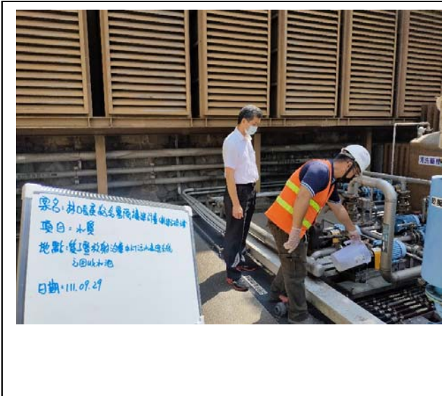
監測項目：回收水(111年9月29日) 監測地點：質子暨放射治療中心污水處理系統之回收水池
